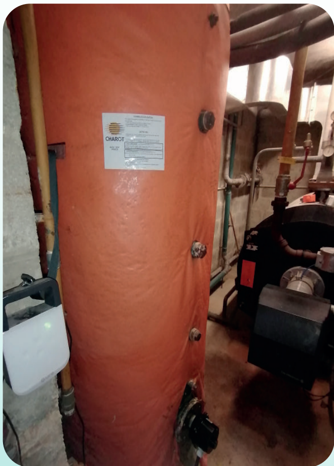
Production d'eau chaude
